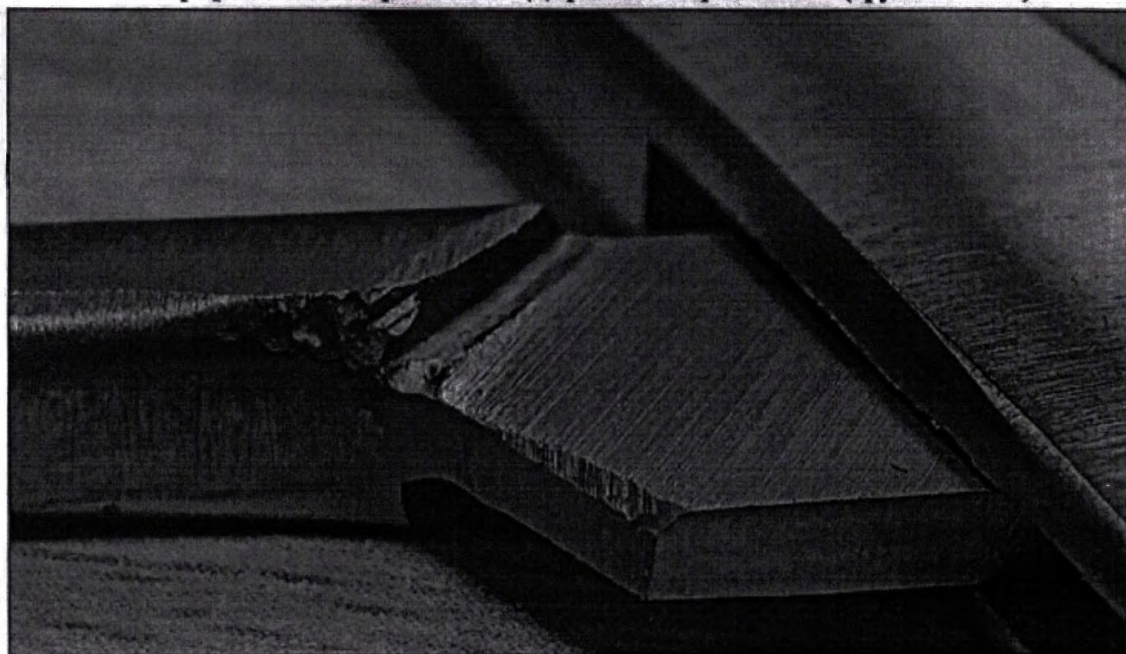
Фотографическое изображение 9 Дефекты поверхностей 3 (крупный план)
